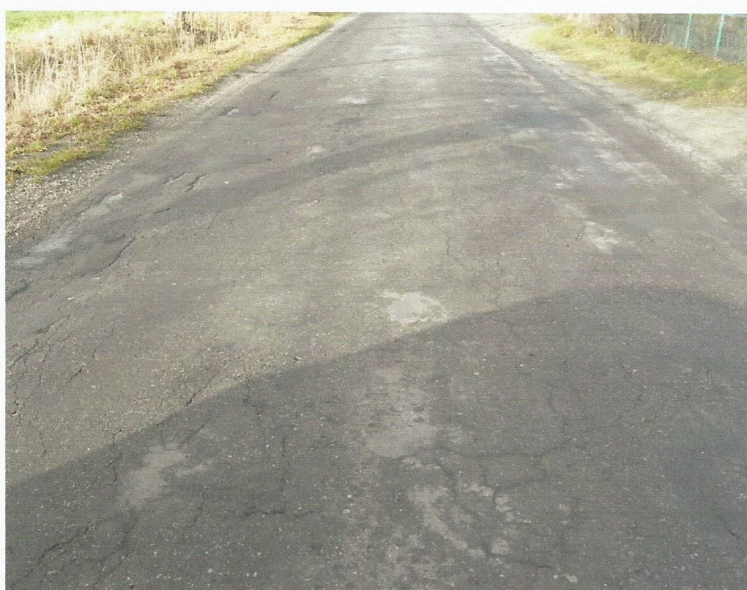
Rysunek nr 4 Nawierzchnia drogi powiatowej nr 4545E w km 0+600 (istniejące poszerzenie do rozbiórki)
